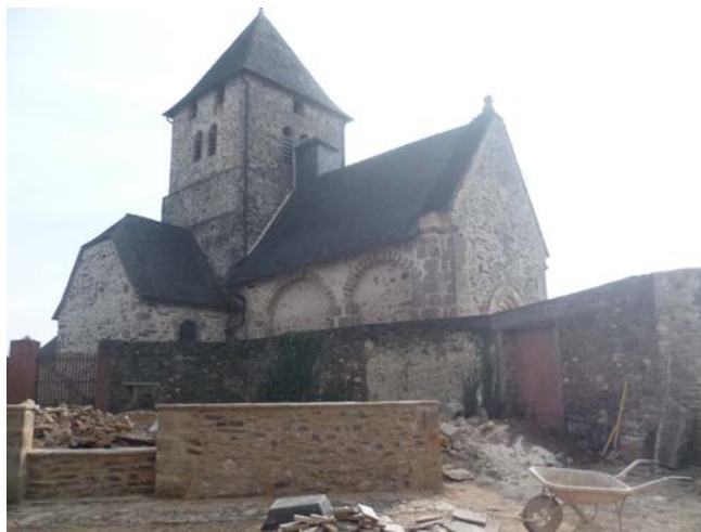
Mur à restaurer
